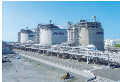
直江津LNG基地
