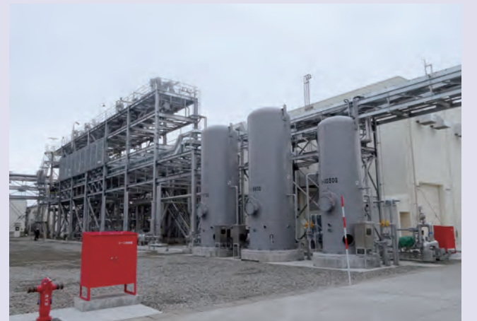
稼働を開始した南長岡ガス田越路原プラントの低圧採収設備
